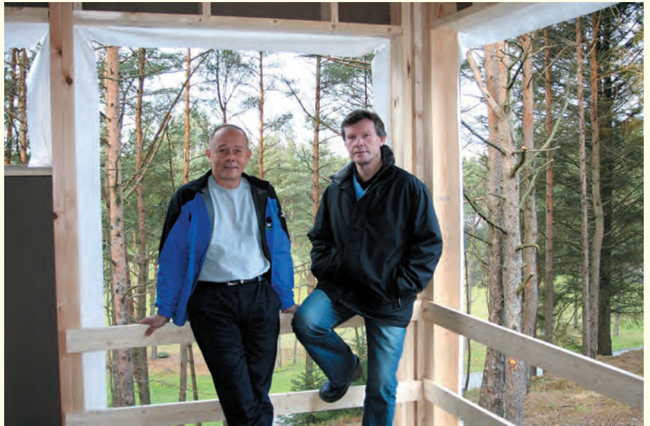
Administrasjonssjef Terje Haukelid (t.v.) sammen med "boss" Steinar Fløisvik i reisverket til det nye tilbygget
