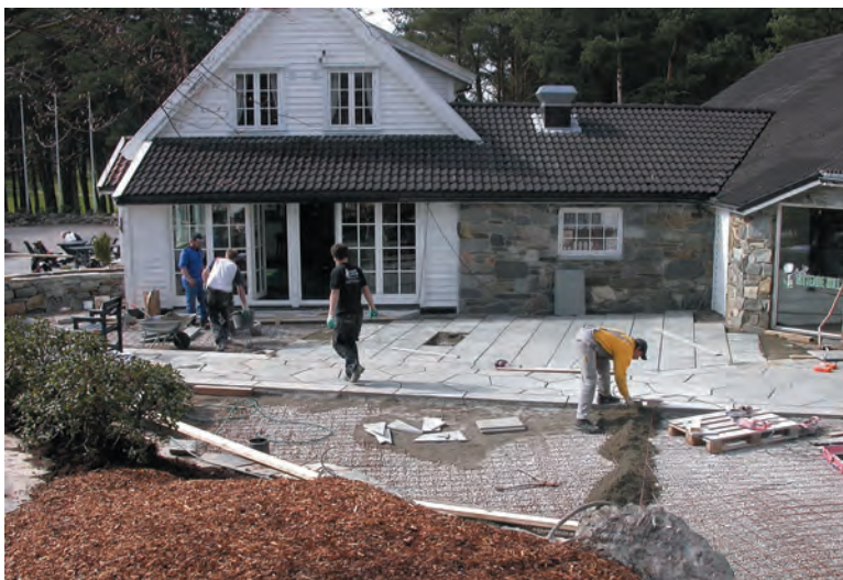
Det var litt av en jobb å skiferlegge uteområdet. Hellene ble lagt i et bestemt system og mønster. Uteplassen virker nå mye større enn før. Den er også blitt enda lunere og har et variert tilbud av solvennlige kroker.
