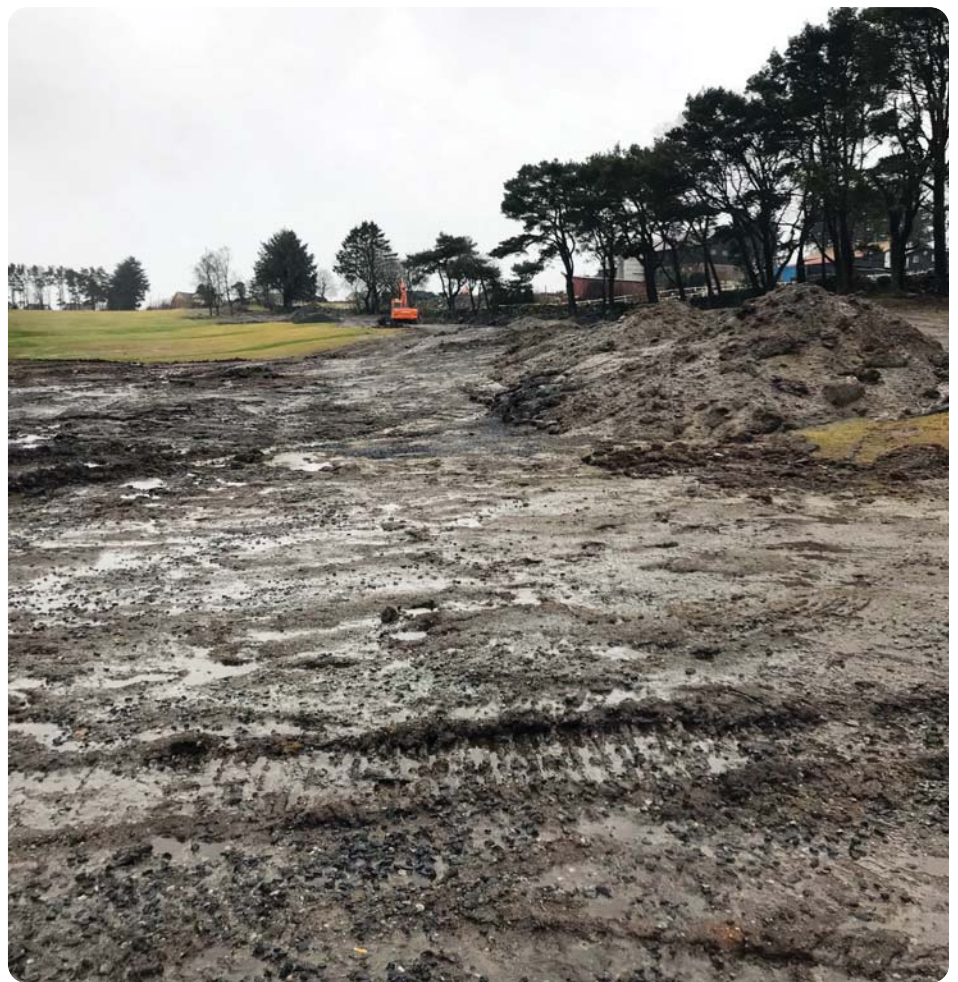
Et betydelig del av fairwayen på hull 6 er berørt av grøftearbeidet. Men det kommer til å bli fint, og en jevnere og tørrere bane vil sikkert alle medlemmene sette pris på.
